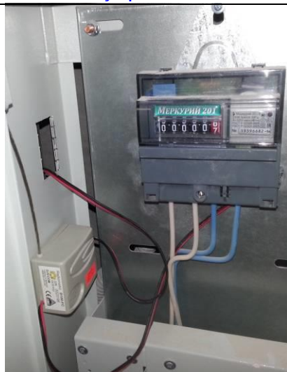
Electricitate – 2 aparate de evidență
