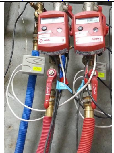
Evidența energiei termice – câte 2 la radiomodul
