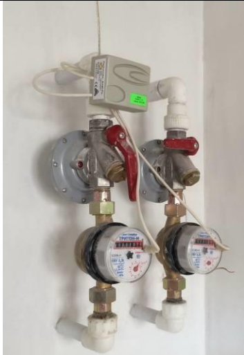
Evidența apei – două intrări
